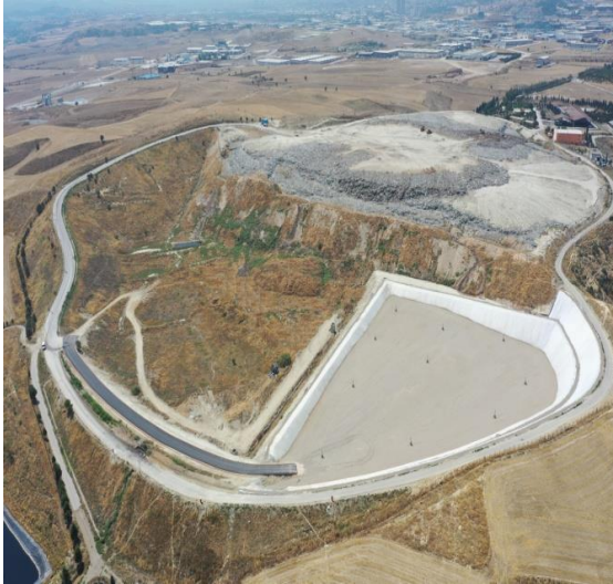
Kumkısıık Katı Atık Bertaraf Tesisi
