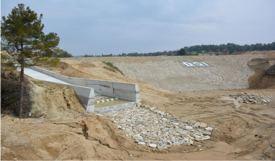
Tavas Yahşiler Göleti: Denizli ili Tavas ilçesine bağlı Yahşiler Mahallesi sınırları içerisinde Yenidere deresi üzerindedir. Proje kapsamında 730 da arazide sulama yapılmaktadır.
