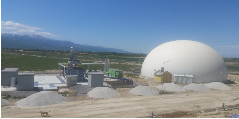
Resim C.15 – Akşehir Metan Gazından Elektrik Enerjisi Üretim Tesisi (Konya Büyükşehir Belediyesi, 2020)
