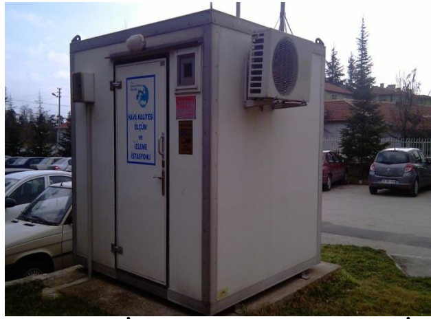
Şekil A.3 - Isparta İlinde Bulunan Hava Kalitesi İstasyonu
