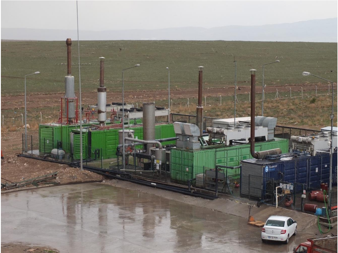
Fotoğraf C.2- Biyogazdan Elektrik Enerjisi Üretim Tesisi
