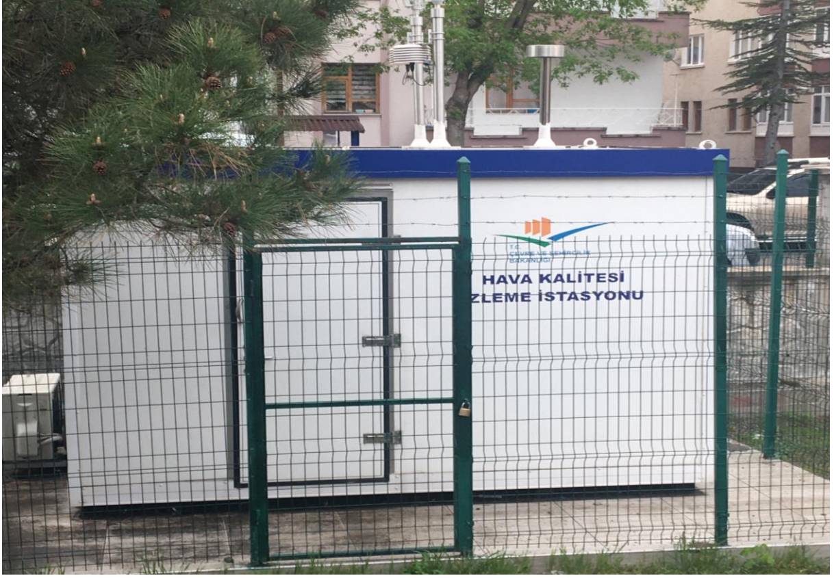
Resim 2. Çankırı Hava Kalitesi İzleme İstasyonu
