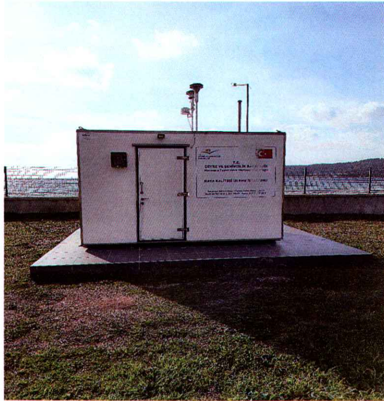
Şekil 12- Çanakkale Merkez İlçe Hava Kalitesi İzleme İstasyonu
