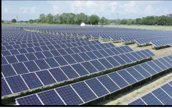
Resim 10: Örnek Güneş Santrali Panel Görünümleri
