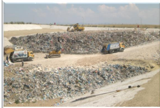
Evsel Atıkların Depolandığı Geçirimsizliği Sağlanmış Lotlar
