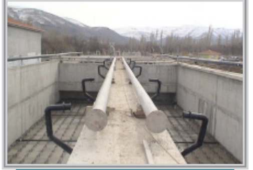
Atık Su Arıtma Tesisi
