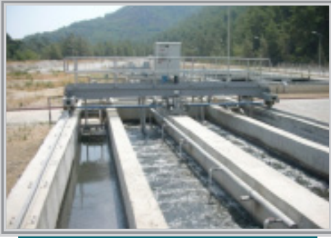
Akyaka-Gökova Atıksu Arıtma Tesisi
