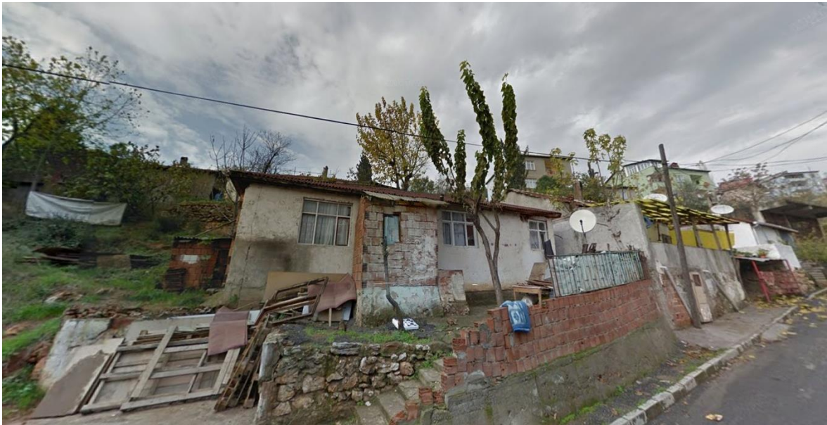
Şekil 5-5: Alan İçinden Kötü Durumdaki Yapılar
