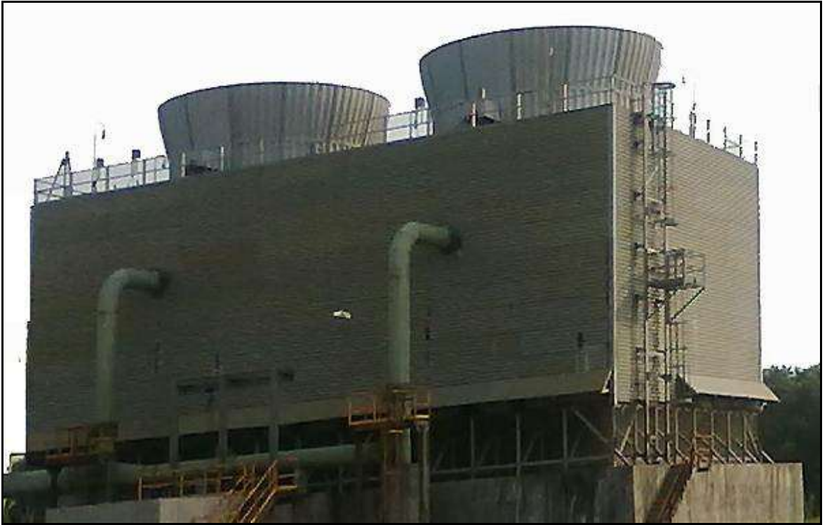
Şekil V.2.1.11. Mekanik Çekişli Islak Tip Soğutma Sisteminden Görünümler
