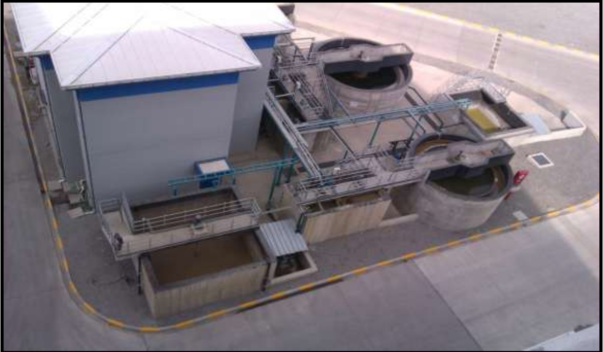
Şekil V.2.5.1. BGD Atık Su Arıtma Tesisi
