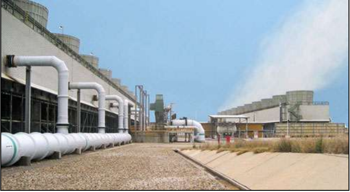
Şekil V.2.1.10. Mekanik Çekişli Islak Tip Soğutma Sisteminden Görünümler
